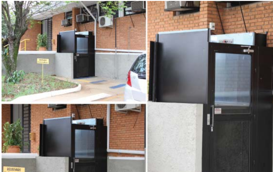
Plataformam elevatória de acessibilidade.
