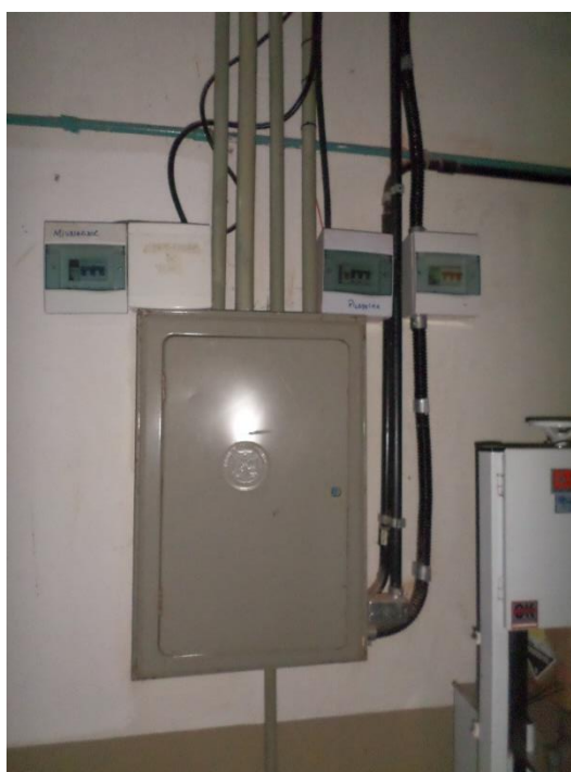
Figura 18. Detalhes do painel de energia elétrica nas dependências do biotério.
