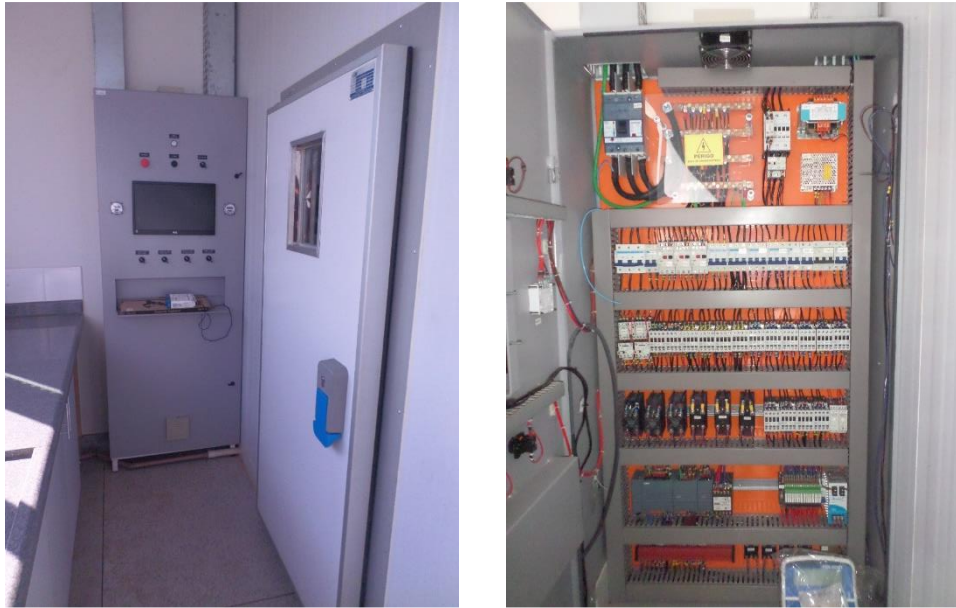
Figura 19. Detalhes das instalações elétricas da câmara de crescimento do Laboratório de Ecotoxicologia
