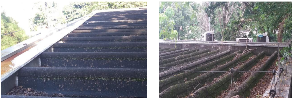
Figura 22. Detalhes do telhado, a ser substituído, do prédio de Ecologia Isotópica do CENA
