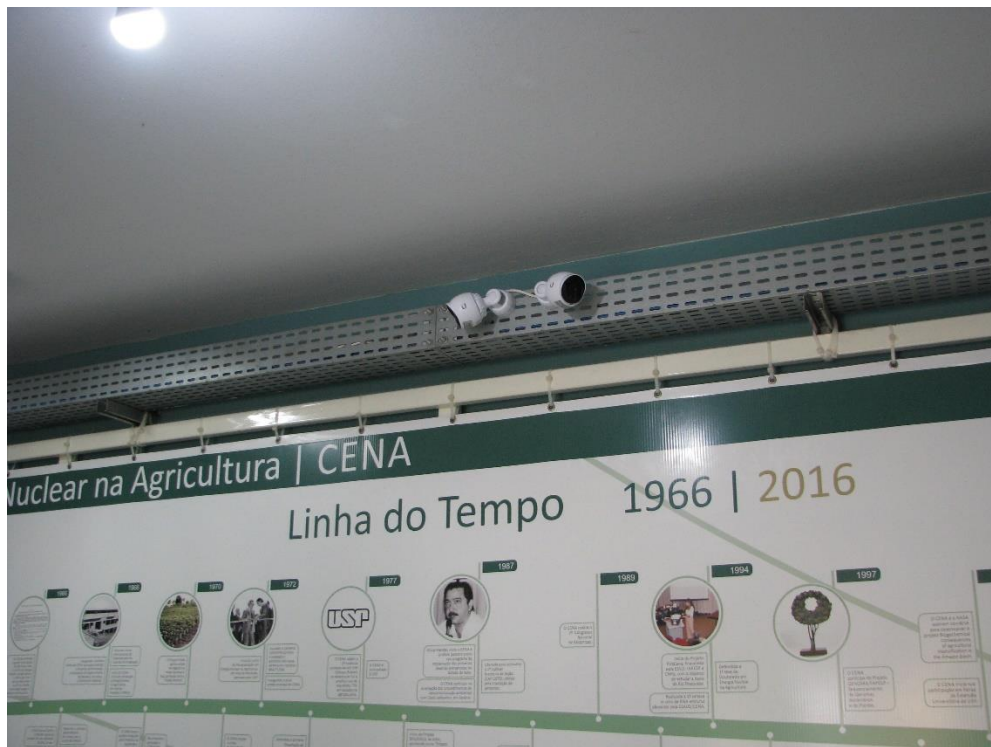
Figura 29. Detalhes do local de instalação das câmeras do prédio principal.
