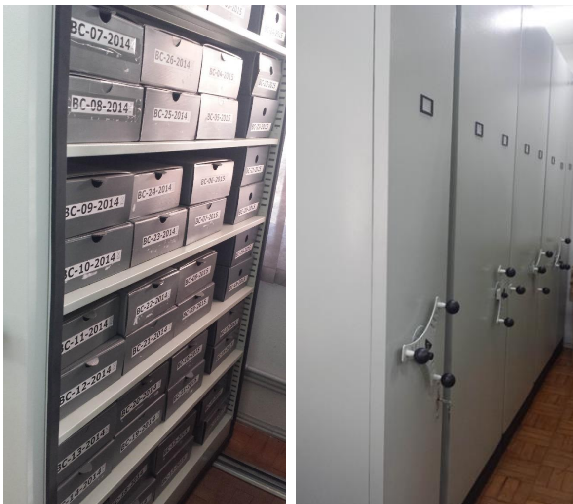
Figura 45. Detalhes do novo arquivo instalado no Setor de Expediente do CENA/USP (2018)
