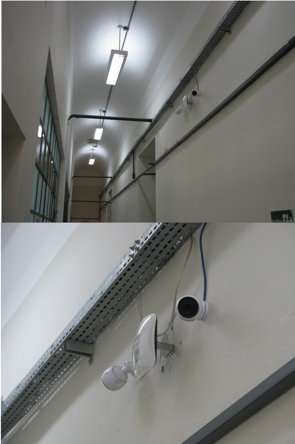
Figura 27. Detalhes das câmeras de monitoramento na Central de Aulas (localização dos equipamentos)
