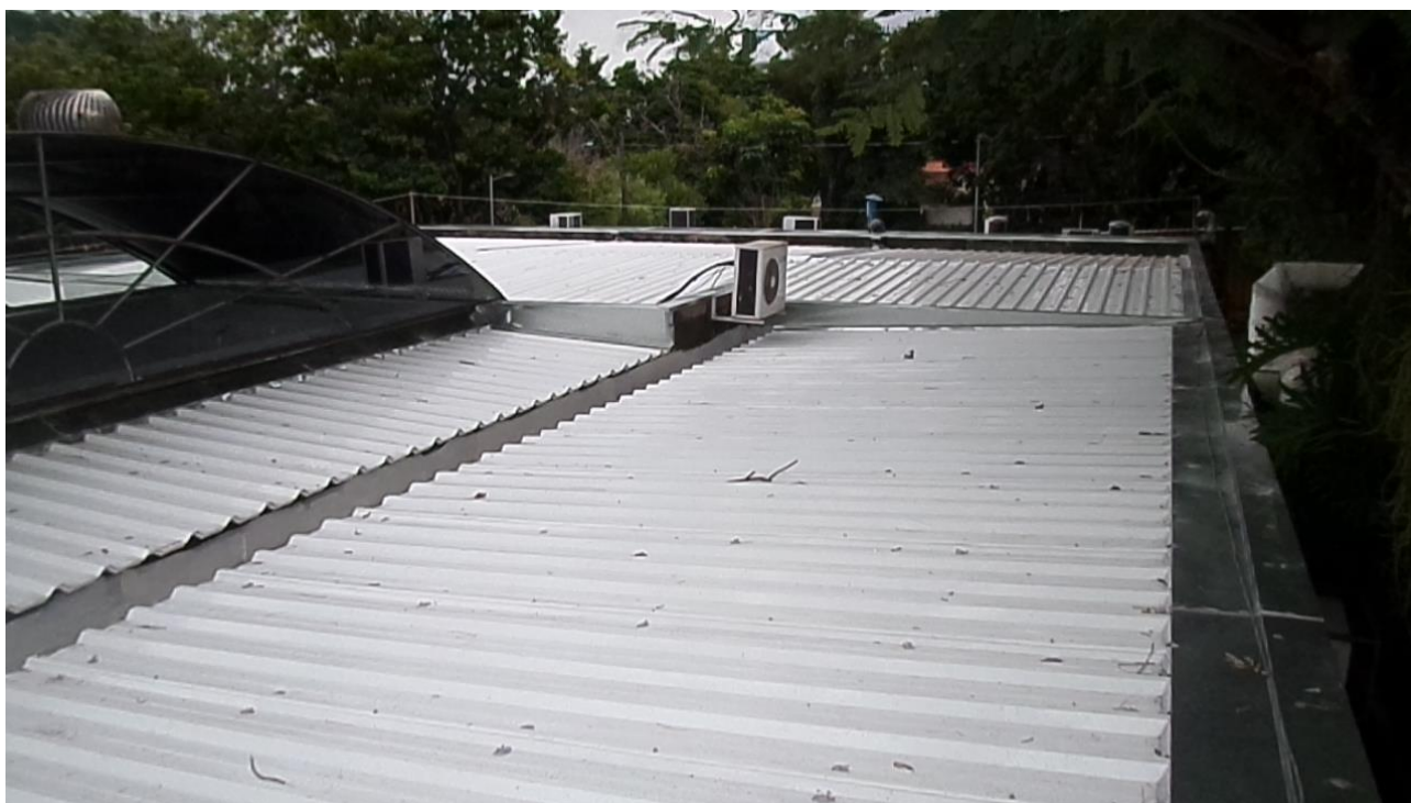
Figura 18. Detalhes do telhado do Laboratório de Ecologia Isotópica (antes e após as reformas)
