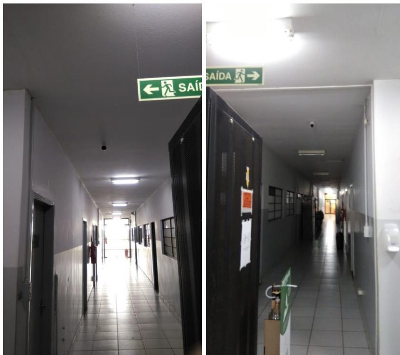
Figuras 40 a 41. Detalhes das câmeras de monitoramento no laboratório Fertilidade do solo (localização do equipamento – área interna)
