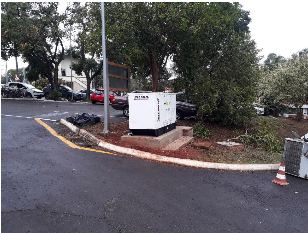
Figura 21. Gerador instalado na Central de Aulas do CENA/USP
