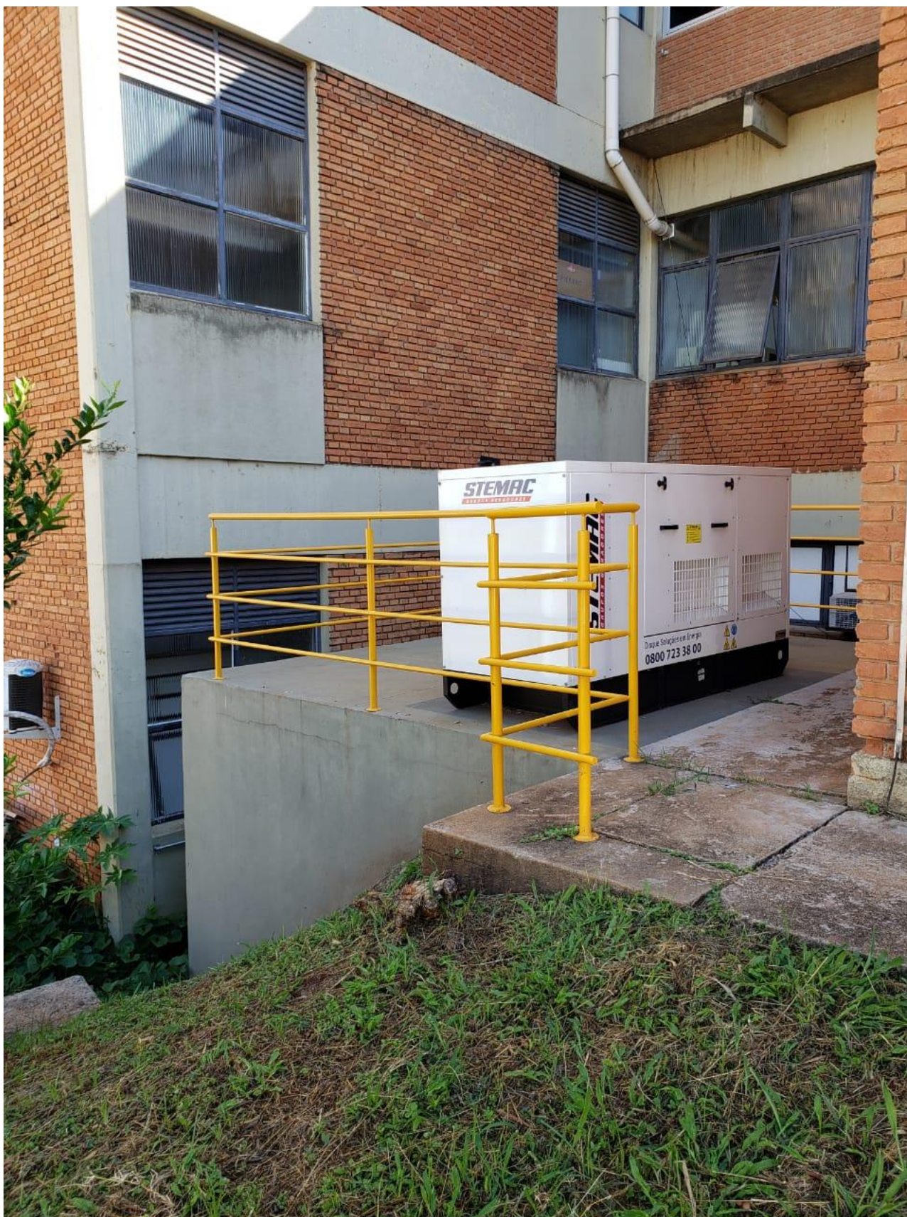
Figura 23. Gerador devidamente instalado ao lado do Predio número 9 (atender ao Biotério do CENA)
