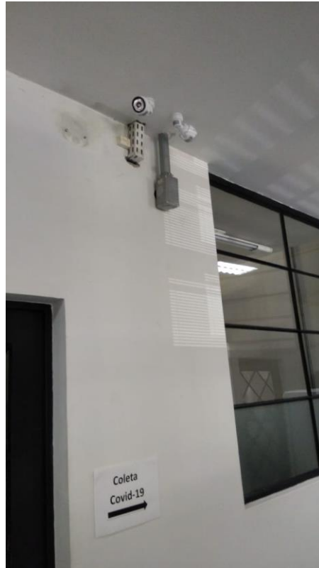
Figura 46. Detalhe da câmera de monitoramento no prédio administrativo (laboratórios) - (localização do equipamento – área interna
