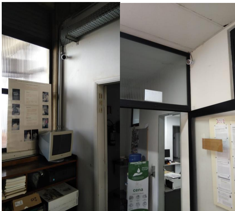
Figuras 44 a 45. Detalhes das câmeras de monitoramento no Prédio 9 - LANA (localização do equipamento – área interna)
